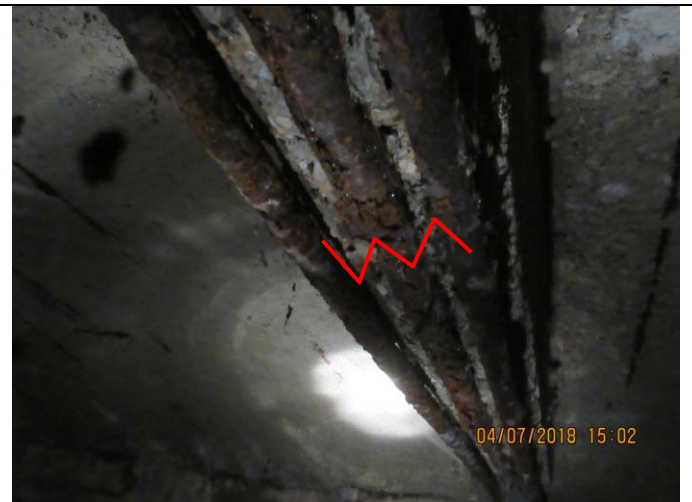
Aciers apparents avec corrosion/cisaillement
