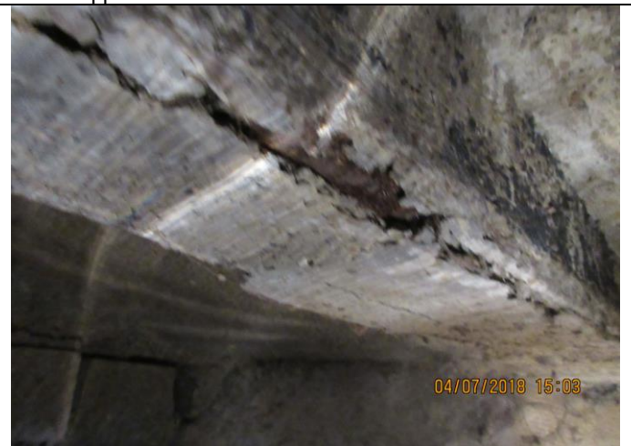
Erosion/départ des bétons d'enrobage
